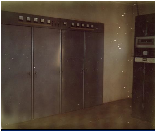
Transmisores de la década del 80 y 90
